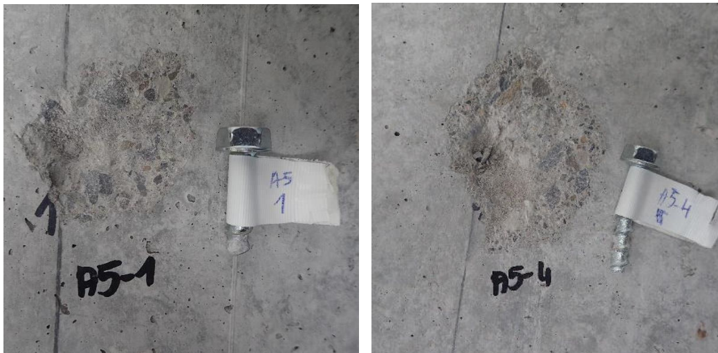
Bild 4-12: Darstellung des Versagens unter Querbelastung mit geringer Verankerungstiefe ( h_{nom} = 20 mm) in Hohldeckenplatten.
