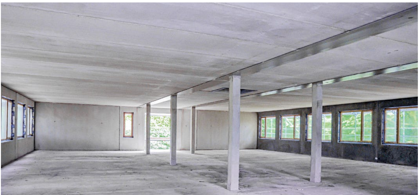
Bild 3. Slim Floor-Konstruktionen mit störungsfreien Unterseiten ermöglichen einfache Leitungsführungen in der Bauphase und bei späteren Nutzungsänderungen. Auch der Flurbereich mit den kurzen Spannweiten wurde im Zuge einer optimierten Baustellenabwicklung mit BRESPA®-Decken eingedeckt (Foto: DW SYSTEMBAU GMBH)
