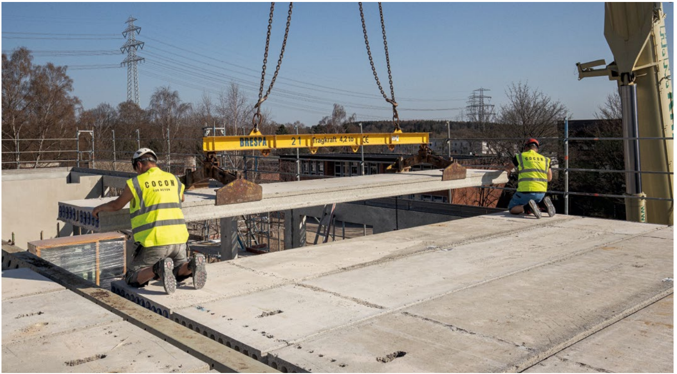
Bild 2. Deckenmontage bei den Klassenhäusern in der Schule Max-Eichholz-Ring, Hamburg: Mit vorgefertigten BRESPA®-Decken entfallen auf den Baustellen aufwändige Schal-, Bewehrungs- und Betonierarbeiten (Foto: Phillip Steiger)
