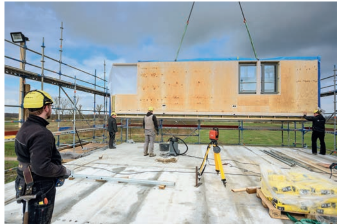
Bild 8. Geschosshohe vorgefertigte Holzwandelemente der Gebr. Schütt KG werden für das Wohnprojekt „Nordkante“ in einem Stück montiert (Foto: Thorsten Scherz)
