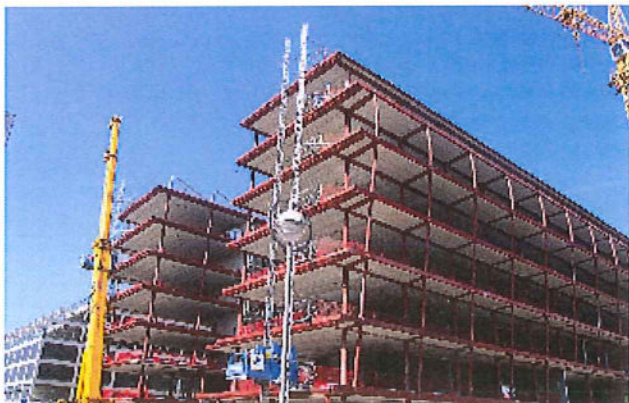
Die Decken des Projektes – Deutsche MED in Rostock – sind aus 32 Zentimeter Spannbeton-Fertigdecken. Alle Geschosse sind frei einteilbar.
