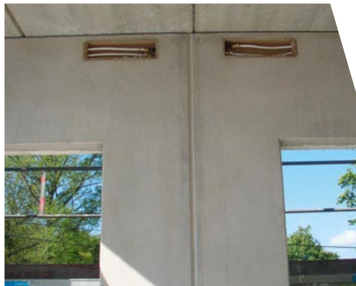
Die Anschlüsse der einzelnen Heizregister liegen oben unter der Decke
