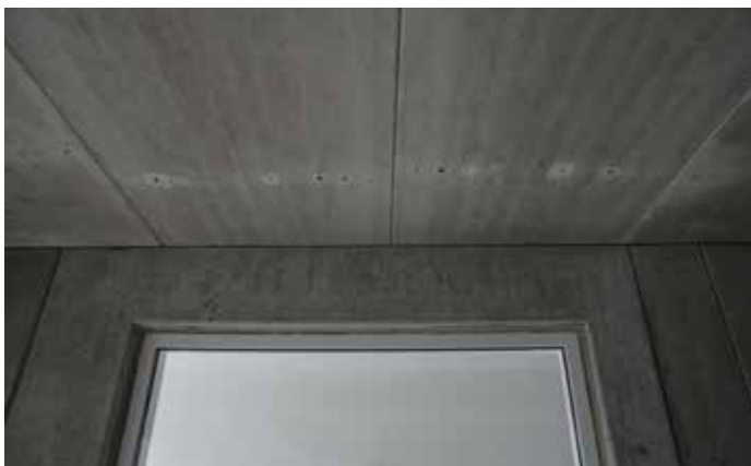
Wasserablaufbohrungen in allen Hohlkammern.
