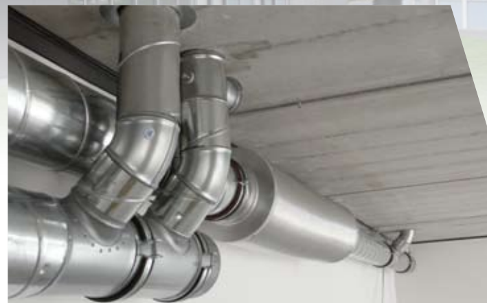
Detailaufnahme der Lüftungsleitungen.
